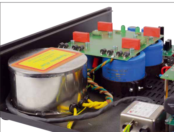
Die speziell für SymphonicLine gefertigten Siebkondensatoren sind nicht weniger beeindruckend als der Trafo
